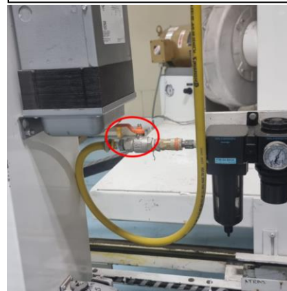
Activación del sistema de aire
