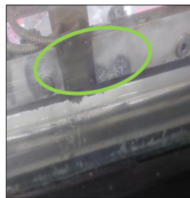
Grumos en canal de adhesivo
